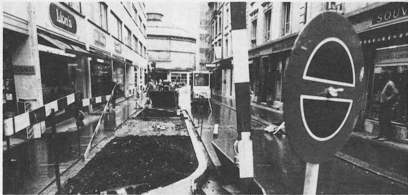
Ende Oktober an der Denkmalstrasse: Die Parkfelder werden aufgehoben und Rabatten für Bäume erstellt.
