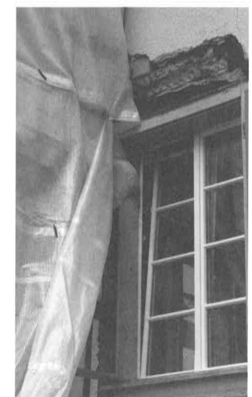
Perfidier Pilz: Das Gebälk hinter der Fassade der Villa Bramberg ist vom Hausschwamm schwer geschädigt. Foto: Hanns Fuchs
