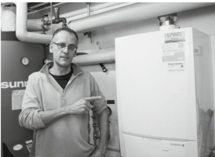
Thomas Scherer zeigt die neue Gasheizung im Keller seines Hauses an der Libellenstrasse.
