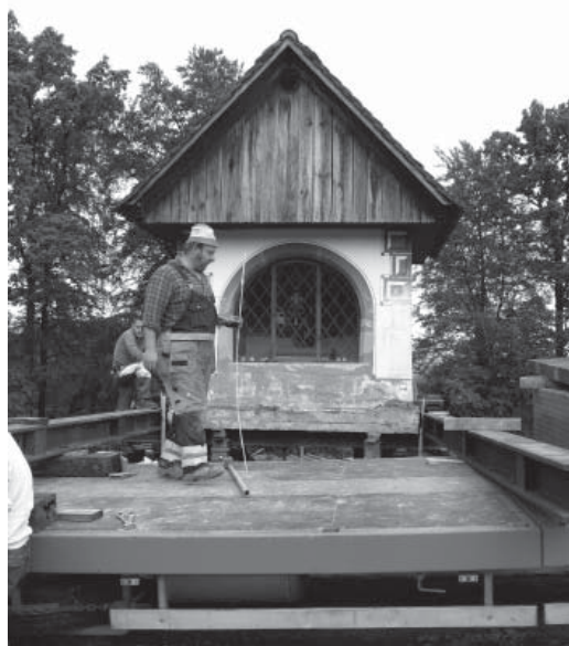
Massarbeit: Das Gerade aufs Schräge bringen. Die Kapelle musste während des ganzen Transports in der Horizontalen gehalten werden.
