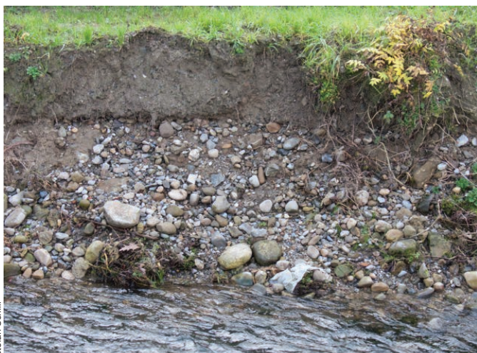
Nach der Entfernung der Blocksteinverbauung kann hier das Ufer frei erodieren. Die Steilwand wird zum potenziellen Brutort des Eisvogels.
